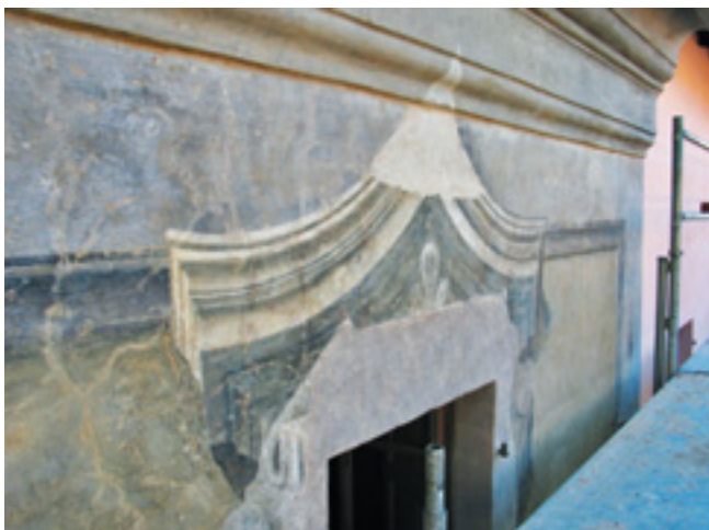
Fig. 12 - Piacenza, palazzo Mischi: particolare della facciata su cantone Cavalli dopo il riequilibrio cromatico tramite esecuzione del neutro sulle parti di nuovo intonaco
